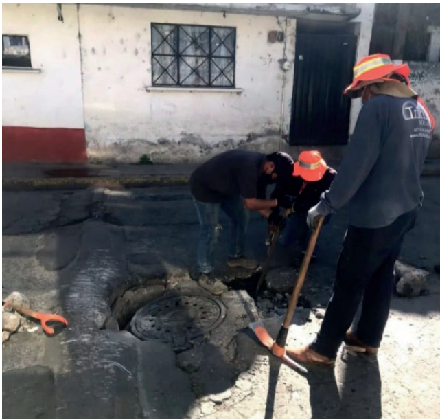
Bacheo calle Guadalupe Victoria
